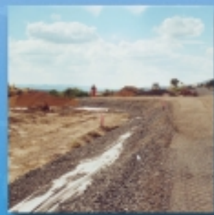
Erdfallüberbrückungen, hier Sangerhausen-Riestedt
